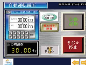
自動運転 / Automatic Operation
